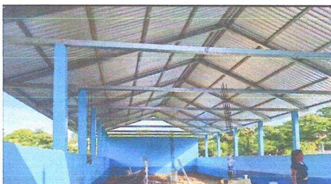
Foto 4: aula 1 Sustitución de lámina, por lamina troquelada, sustitución de capote para lamina troquelada y sustitución de estructura de soporte de madera por metal.
