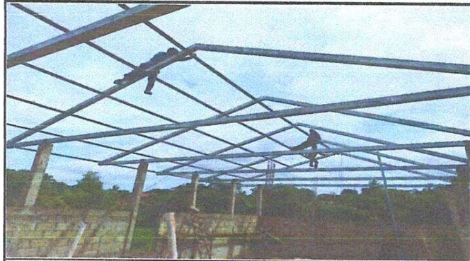
Foto1: Sustitución de lámina, por lámina troquelada, sustitución de capote para lámina troquelada y sustitución de estructura de soporte de madera por metal.
