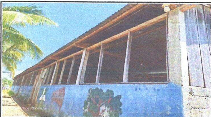
Foto 3: Aulas 1,2,3 Sustitución de lámina, por lámina troquelada, sustitución de capote para lamina troquelada y sustitución de estructura de soporte de madera por metal.
