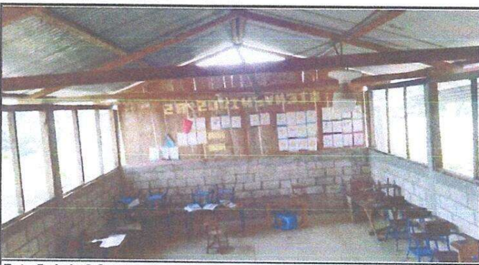
Foto 5: Aula 2 Sustitución de lámina, por lámina troquelada, sustitución de capote para lámina troquelada y sustitución de estructura de soporte de madera por metal.
