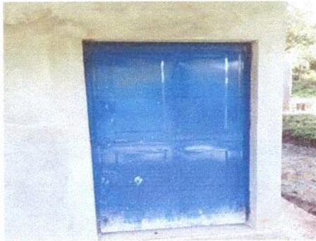
Foto 3: Sistutucion de puerta de madera por metal.
