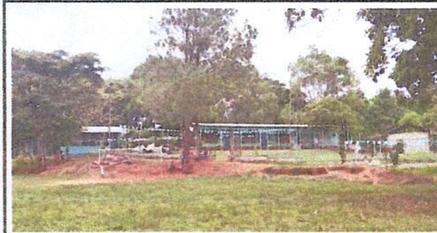
Foto 5: Muro perimetral en malas condiciones.
