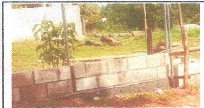
Foto 5: Muro perimetral en malas condiciones.
