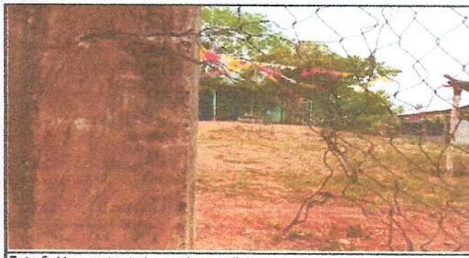
Foto 5: Muro perimetral en malas condiciones.
