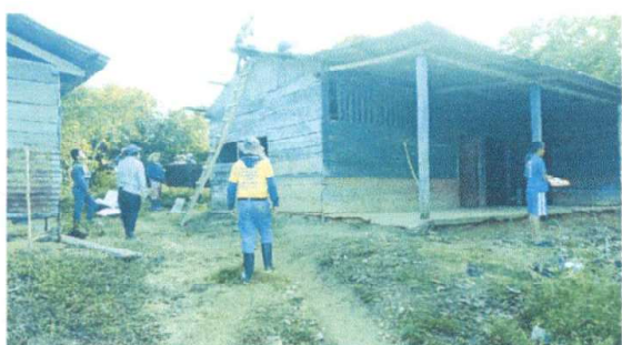
Foto 3: estructura de la cocina en malas condiciones.
