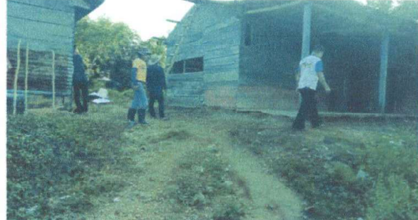
Foto 4: Láminas y estructura de madera en mal estado
