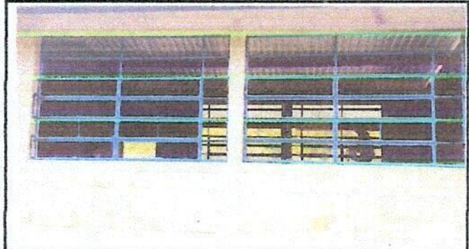
Foto 2: Sustitución de ventanas de madera por ventanas de metal del centro educativo
