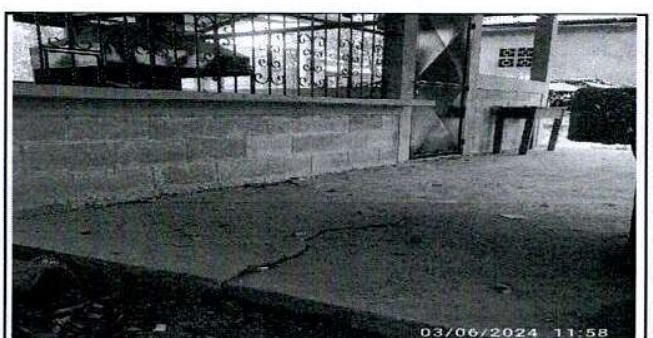
Foto 6: piso en muy mal estado con grietas.
