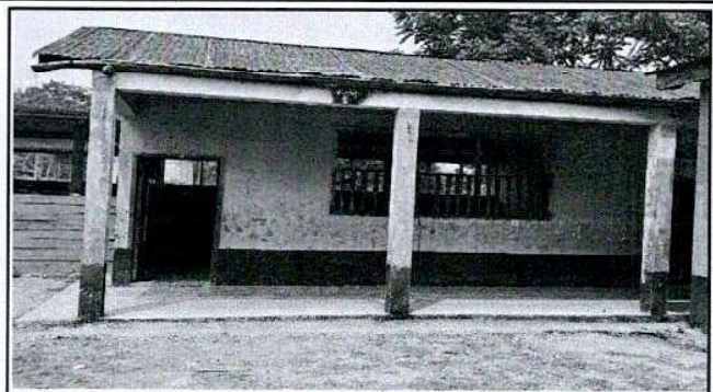
Foto 2: Vista externa de láminas en mal estado.
