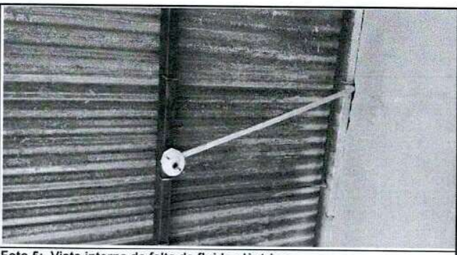
Foto 5: Vista interna de falta de fluido eléctrico.
