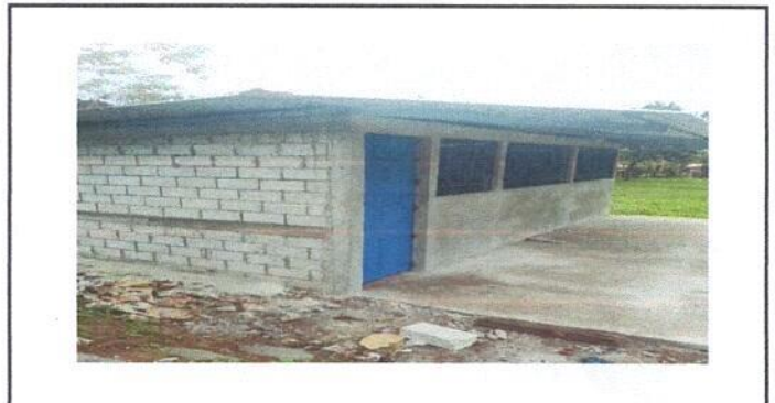
Foto 4: Sustrucción de piso de torta de concreto
