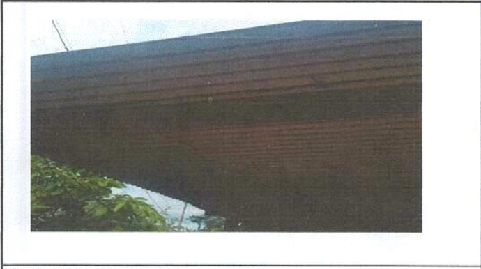
Foto 1: Sustrucción de lámina
