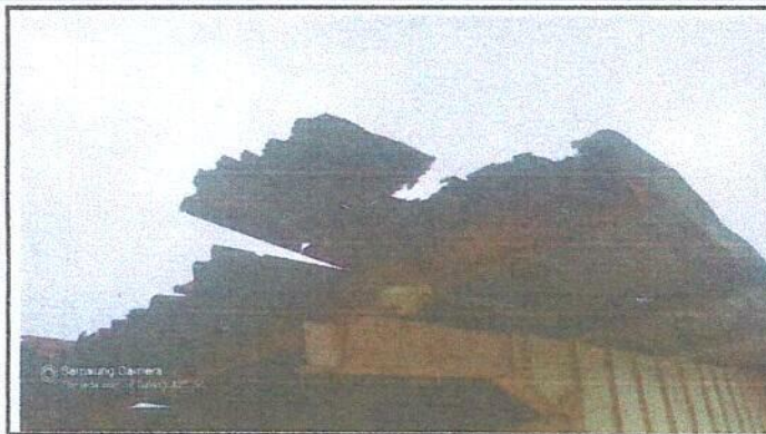
Foto 2: Las láminas y los capotes totalmente deteriorad.
