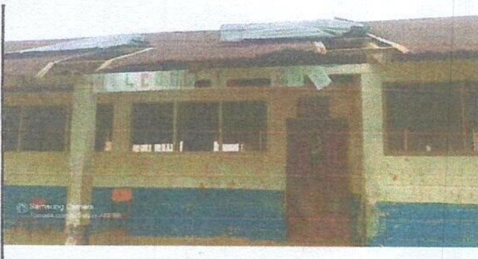
Foto 5: las puertas estan en malas condiciones.
