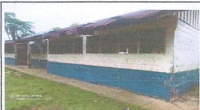
Foto 1: La escuela totalmente deteriorado el techado por las fuertes lluvias
