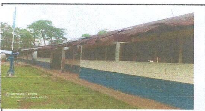
Foto 6: las ventanas estan en malas condiciones.
