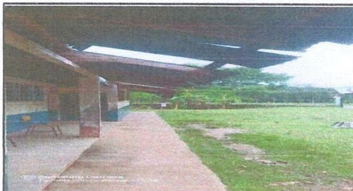
Foto 4: corredor de la escuela todo el techado deteriorado por fuertes vientos y lluvias
