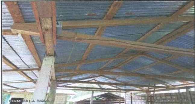
Foto 2: Sustitución de estructura de soporte de madera, por metal del centro educativo público
