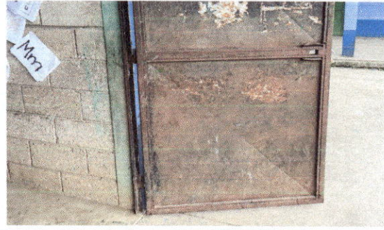
Foto 8: PUERTAS DE METAL DE LAS AULAS, EN MAL ESTADO Y CON CHAPAS COMPLETAMENTE RETIRADAS DE SU ESPACIO.
