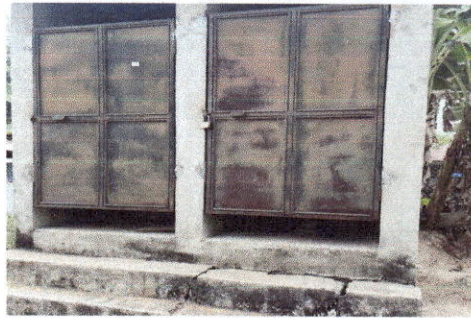
Foto 10: PUERTAS DE METAL DE SANITARIOS CON FALTA DE MANTENIMIENTO Y PASADORES DAÑADOS.
