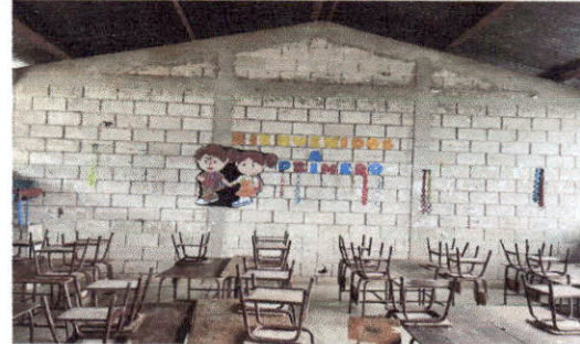
Foto 4: AULAS DEL MODULO, SIN PINTURA EN SUS MUROS INTERIORES.
