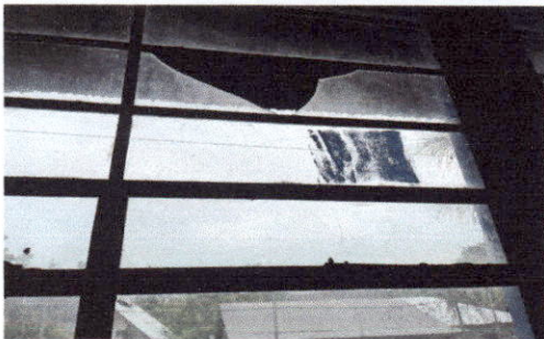
Foto 5: VENTANAS EXISTENTES, DETERIORADAS Y QUEBRADAS.
