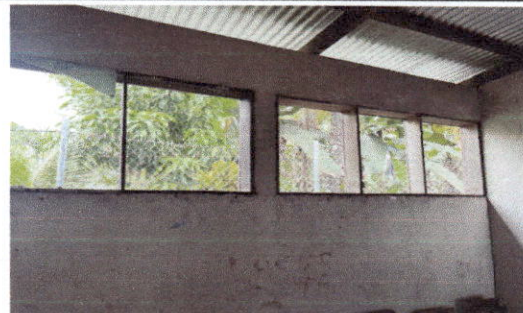
Foto 6: NO SE CUENTA CON VENTANAS EN LAS AULAS, CONTANDO UNICAMENTE CON MARCOS DE MADERA Y CEDAZO.
