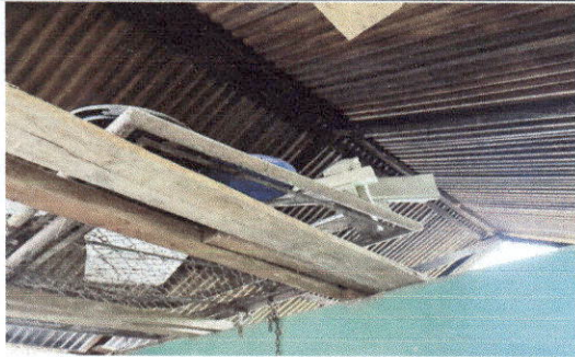
Foto 9: LAMINA DE AULA CON PROBLEMAS DE FILTRACIONES DE AGUA Y PERFORACIONES.
