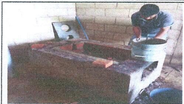
Foto 8: Sustrucción de plancha de metal de tres hornillas.
