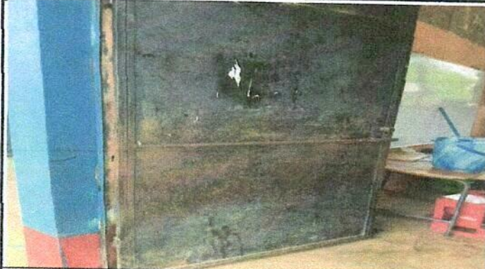
Foto 1: Mantenimiento a estructura de puerta de metal (lijado, cepillado, y aplicación de pintura)
