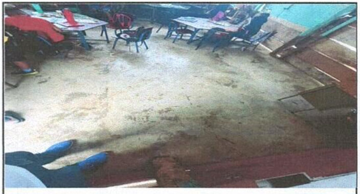
Foto 4: Piso dañado en la parte sur.
