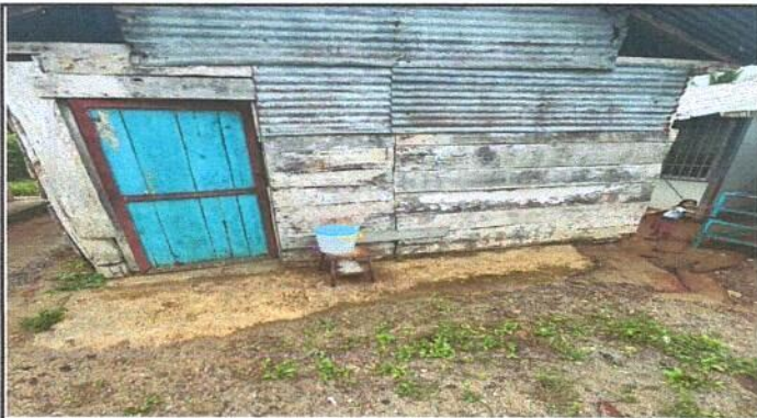
Foto 3: Puerta de madera en malas condiciones.
