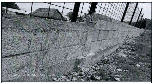
Foto 6: MURO PERIMETRAL: Se decide repellar el cerco perimetral para mayor durabilidad del material.
