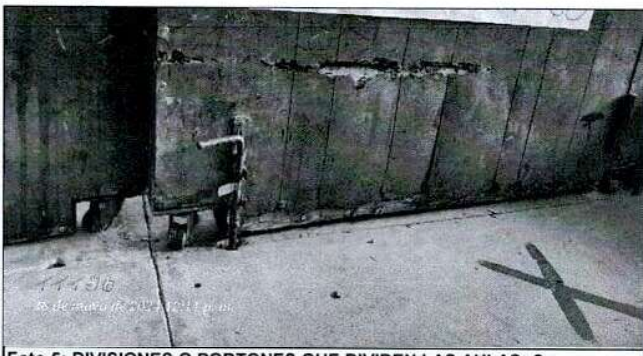
Foto 5: DIVISIONES O PORTONES QUE DIVIDEN LAS AULAS: Se encuentran en mal estado y corren peligro la vida de los niños y niñas y tambien de los docentes.
