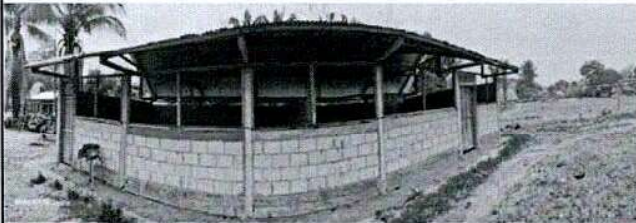
Foto 3: Estructura de madera en mal estado.
