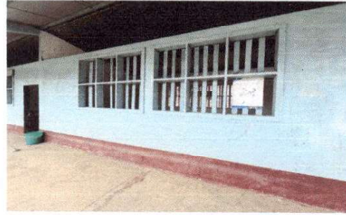
Foto 6: PINTURA EXTERIOR DEL MODULO SIN MANTENIMIENTO.
