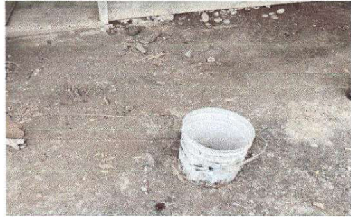
Foto 8: CORREDOR DEL AREA DE COCINA, SIN PISO ACTUALMENTE.
