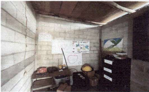
Foto 3: MUROS INTERIORES DEL MODULO SIN PINTURA APLICADA.
