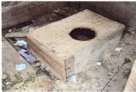
Foto 10: SANITARIOS CON LETRINAS DE MADERA Y SIN PISO.
