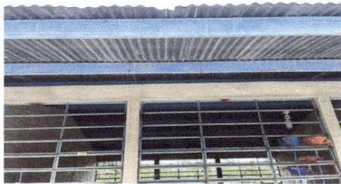
Foto 5: LAMINA DETERIORADA DE MODULO DE AULAS.
