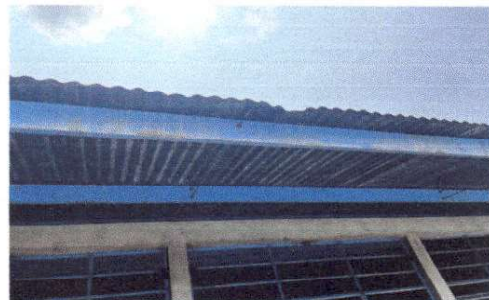
Foto 6: NO SE CUENTA CON CANAL DE BAJADA DE AGUA EN EL MODULO, OCASIONANDO PROBLEMAS DE AGUA.
