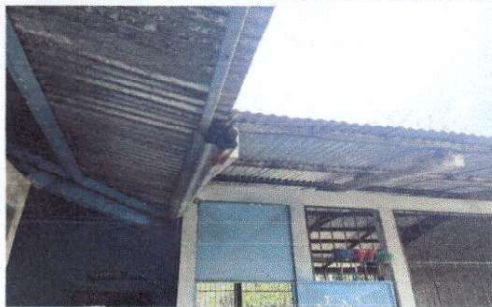
Foto 7: SECTORES DEL MODULO COMPLEMENTADO CON CANALES DE BAJADAS DE AGUA, IMPROVISADAS CON LA MISMA LAMINA.
