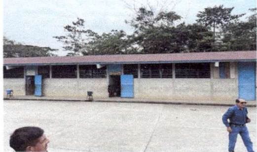
Foto 2: VISTA EXTERIOR DE MODULO DE AULAS, CON LAMINA EN MALAS CONDICIONES.
