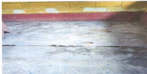
Foto 6: imagen del piso muy deteriorado donde sale agua.
