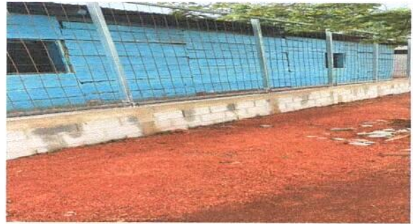
Foto 4: Muro perimetral sin repello
