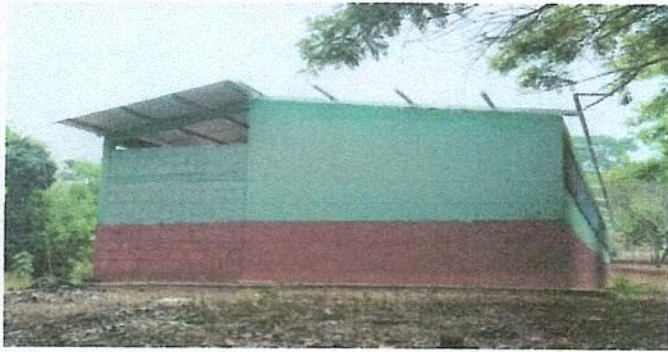
Foto 1: ESTRUCTURA DE TECHO. DESMONTAJE Y COLOCACION DE LAMINAS, POR LAMINAS TROQUELADA ALUZINC 26
