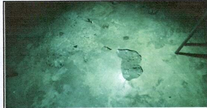
Foto 6: Piso quebrados, riesgo muy grande para los niños.
