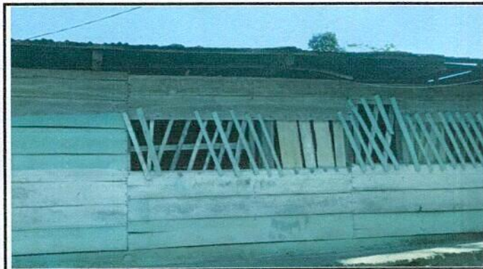
Foto 3: ventanas en mal estado.
