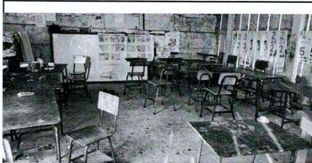
Foto 3: PISO EN MALAS CONDICIONES
