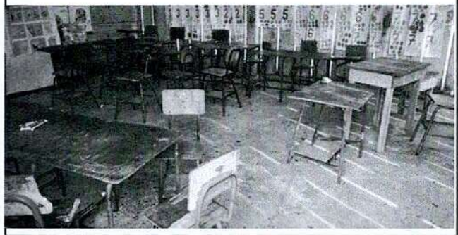
Foto 2: PISO EN MALAS CONDICIONES
