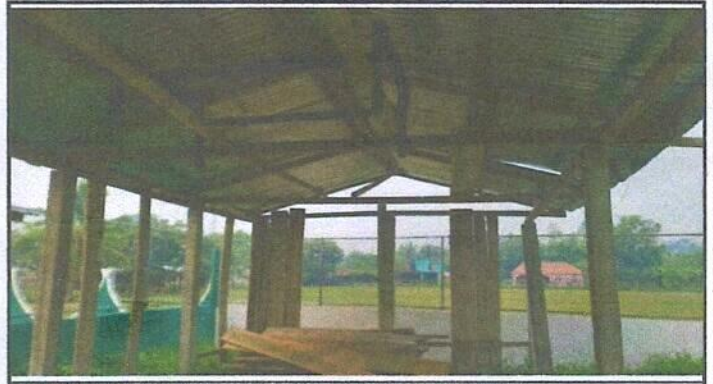
Foto 2: ESTRUCTURA DE LA COCINA EN MAL ESTADO
