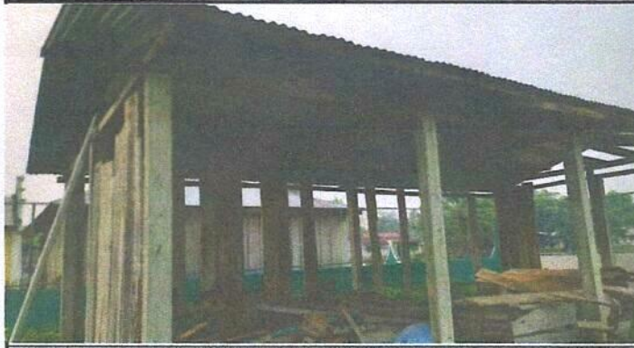
Foto 1: VISTA GENERAL DEL ESTADO DE LA COCINA
