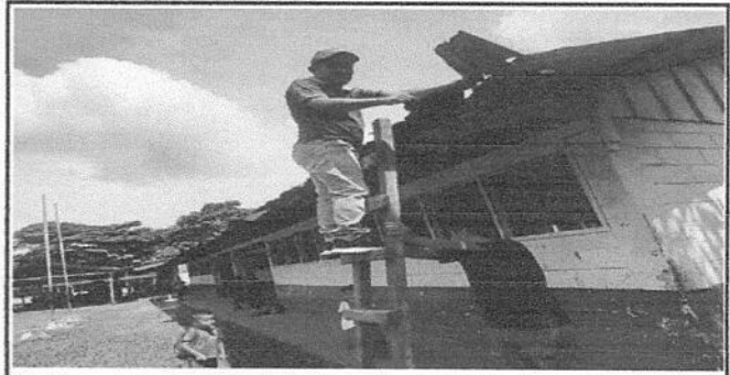
Foto 2: Afección severa en láminas del módulo 2
