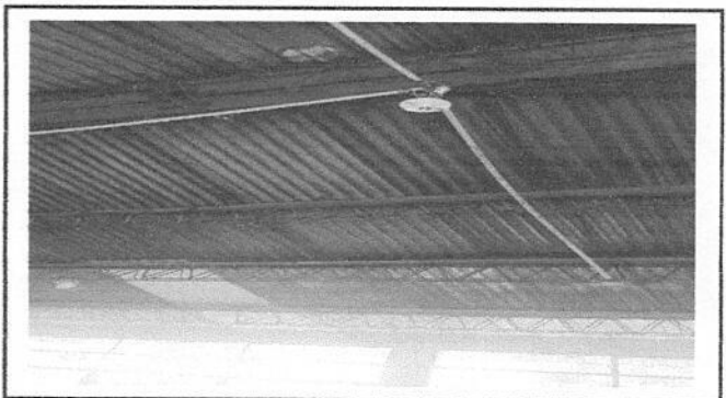
Foto 4: Láminas muy antiguas y deterioradas.
