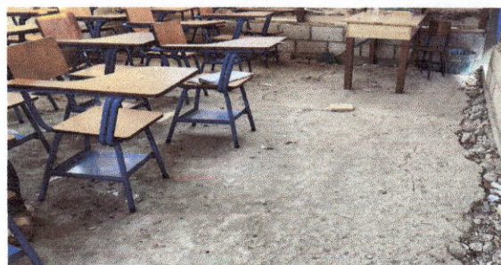
Foto 6: TORTA DE AULA EN MALAS CONDICIONES, CON REMATES EN MUROS INCOMPLETOS.
