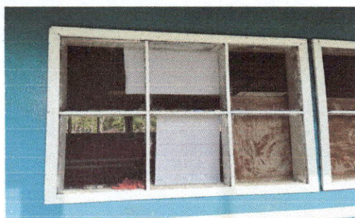
Foto 3: LAS AULAS ACTUALMENTE CUENTAN CON VENTANAS DE MADERA Y CEDAZO, SIN VENTANERIA DE VIDRIO.
