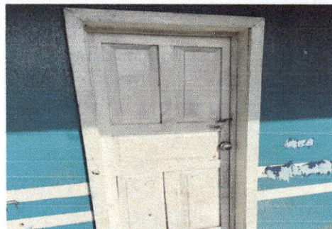
Foto 4: PUERTAS DE MADERA DE AULAS, SIN MANTENIMIENTO PICADAS Y CON CHAPAS CAIDAS.
