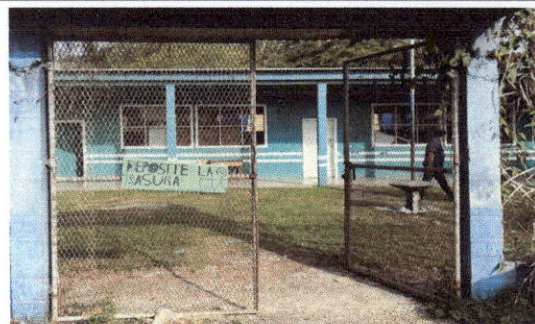
Foto 2: PORTON PRINCIPAL DEL ACCESO A LA ESCUELA DETERIORADO.
