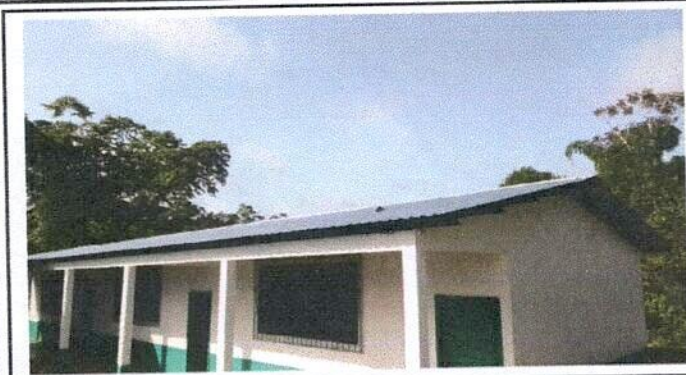
Foto1: Trabajo finalizado del mantenimiento a la estructura de metal y cambio de lamina. Tambien se refleja la pintura a las paredes.
