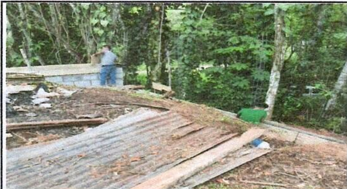
FOTO 3. Muro y Malla levantadas
