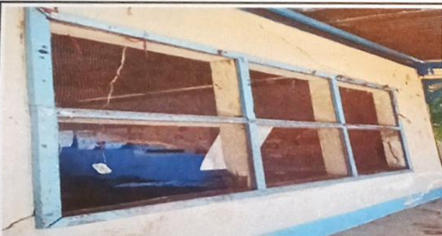
Foto 5: Ventana en malas condiciones
