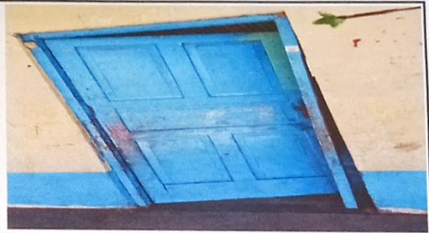
Foto 4: Puertas totalmente deterioradas
