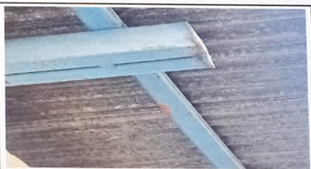
Foto 6: Estructura de metal con oxido
