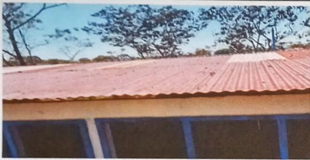
Foto 3: Lamina en muy mal estado
