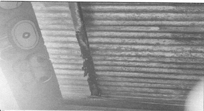
Foto 5: Costaneras oxidadas a punto de quebrarse.
