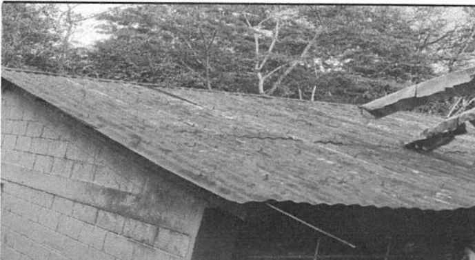
Foto 3: Láminas en muy mal estado, todos con agujeros.
