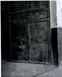
Foto 5: PUERTAS EN MALAS CONDICIONES.
