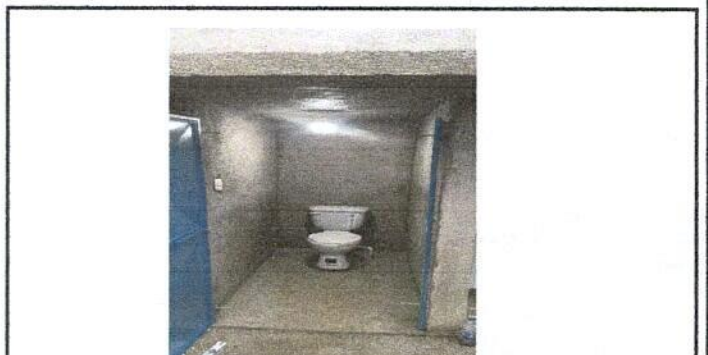
Foto 6: Sistema electrica en los baños funcionando
