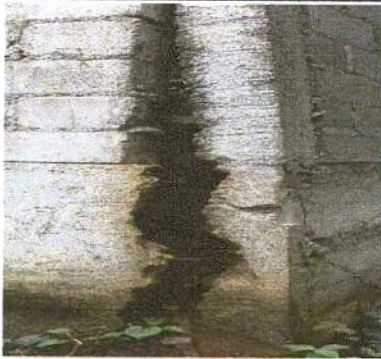
Foto 5: pared de baños en mal estado
