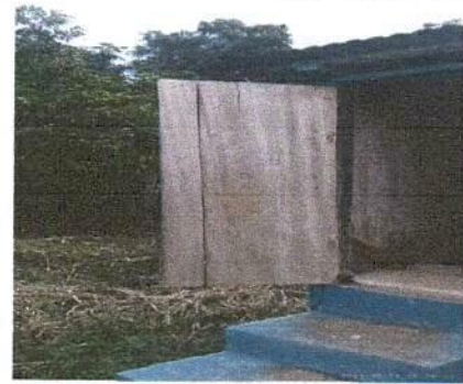
Foto 6: puertas de baños en mal estado
