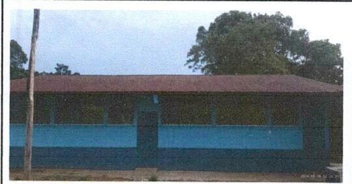
Foto1: Se necesita cambiar techo
