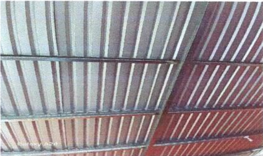
Foto 3: Módulo de cocina. Sustitución de estructura de soporte de madera por metal.
