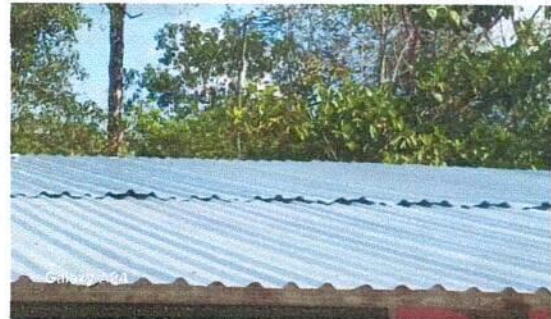
Foto 4: Módulo de aula. Sustrucción de techo de lámina por lámina troquelada aluzinc calibre 26.
