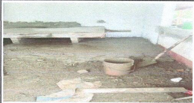
Foto 2: Módulo de cocina. Sustrucción de estufa rural (Completa) Incluye chimenea y plancha de metal.
