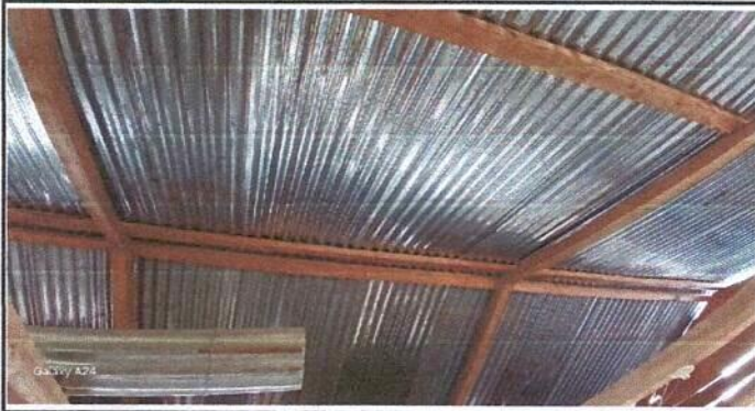
Foto 3: MODULO DE COCINA Sustitución de estructura de soporete de madera por metal
