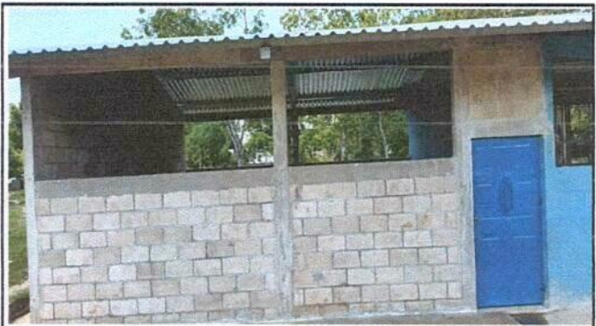
Foto 4: Parte frontal de aula con necesidad de instalación de balcon
