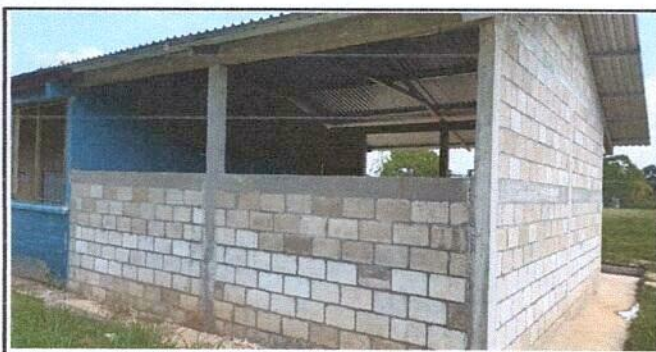
Parte trasera de aula nueva con necesidad de instalación de balcon
