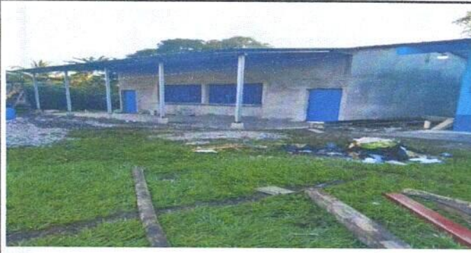
Foto 3: Techo dañado por laminas troqueladas.
