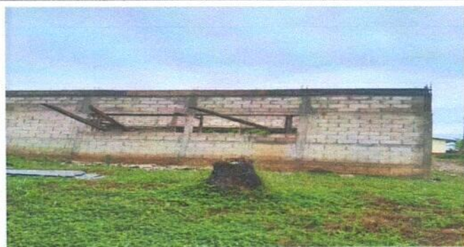
Foto 3: Techo dañado por laminas troqueladas.
