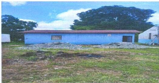
Foto 3: Techo dañado por laminas troqueladas.
