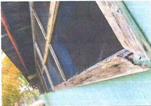
Foto 3: Ventanas deterioradas de maderas
