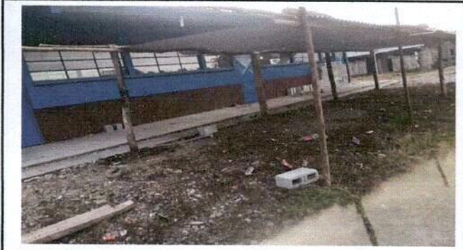
Foto 1: Vista frente a la escuela donde es necesario intervenir la infraestructura del corredor.
