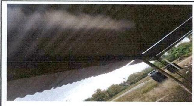
Foto 2: Material de la cubierta de lamina en mal estado.
