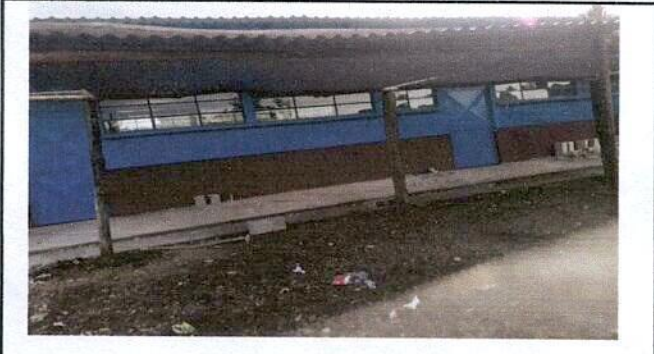
Foto 3: bigas y toda la estructura de madera podridas y mal estado.
