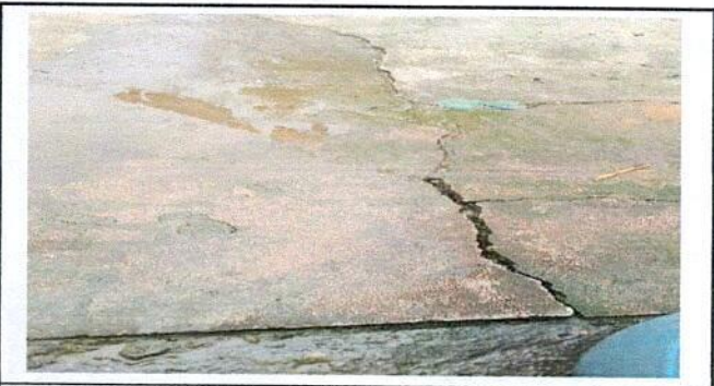
Foto 5: El piso de cocina muy agrietado.
