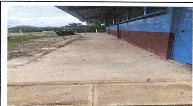
Foto 4: Necesidad de reparación de piso en el corredor del Modulo I.
