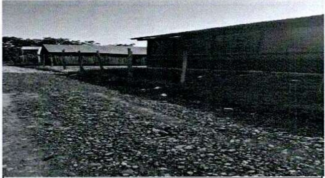
Foto 4: Base de concreto para perímetro que necesitan ser sustituidos.
