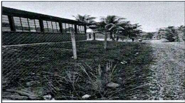
Foto 2: Maya dañada del perímetro del centro educativo.
