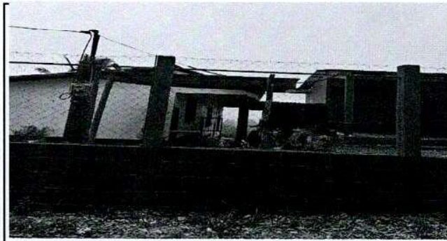
Foto 3: Estructura del patio en malas condiciones
