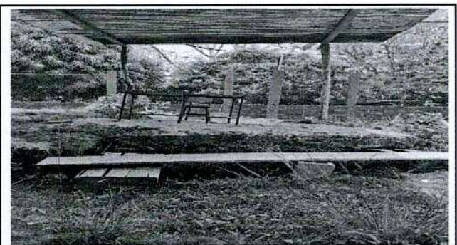
Foto 4: Lamina y estructura de madera en mal estado
