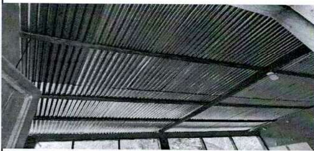
Foto 3: Estructura de madera a cambiar por metal.
